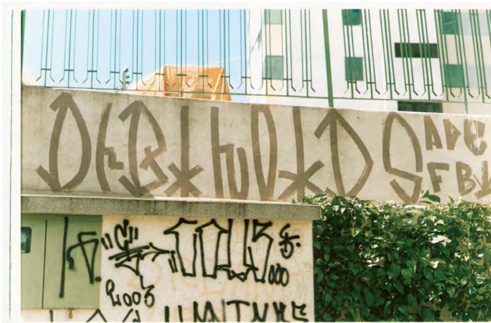
Fachada pichada del caja en centre del São Paulo. Fotografia: Celso Rosa
